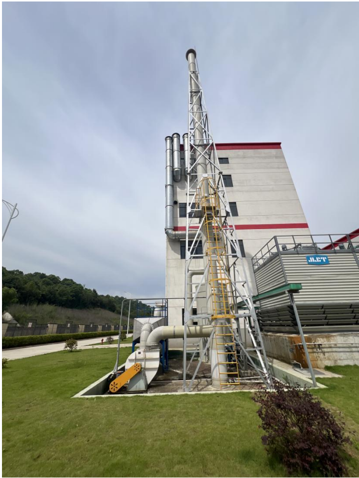
废气处理装置（水冷+水喷淋+树脂吸附）
